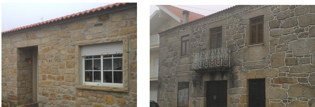
Figura 80: Exemplos de assentamento tradicional de alvenaria em pedra no Centro Urbano da Vila de Sernancelhe
