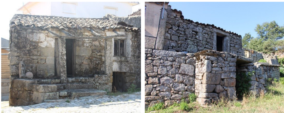
Figura 34 – Edifícios em mau estado de conservação, à esquerda: Rua do Lugarinho; e à direita: Edifício 8 209.
