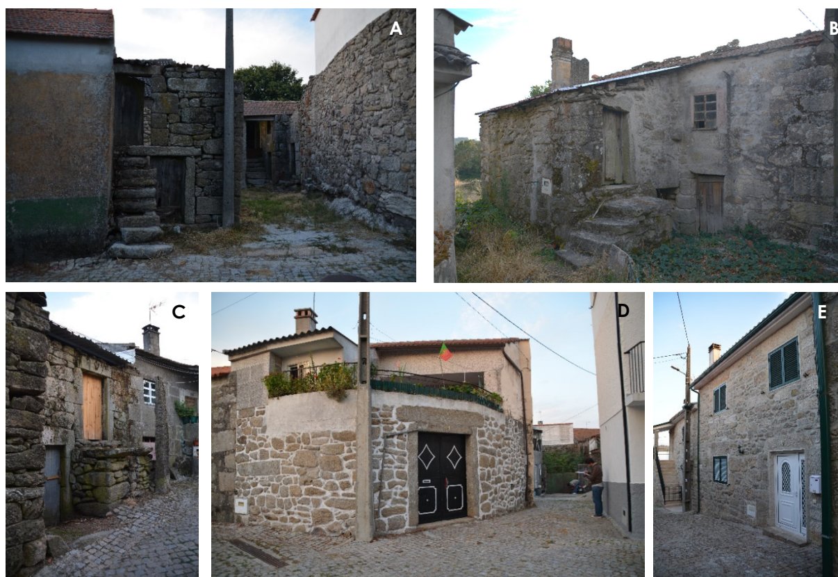
Figura 19- Exemplos de edifícios com diferentes estados de conservação: A – Péssimo estado; B – Mau estado; C – Médio estado; D – Bom estado; e E – Excelente estado.
