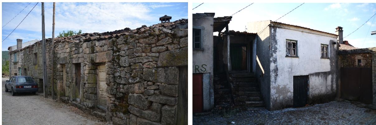
Figura 22: Edifícios em mau estado de conservação: Rua de Santa Quitéria e Rua da Portinha
