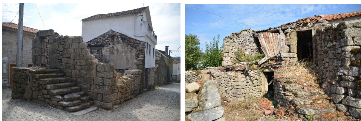
Figura 23: Edifícios em péssimo estado de conservação: Rua da Amoreira e Rua Cimo do Povo
