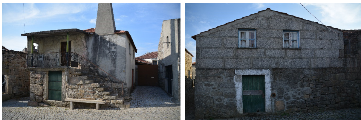
Figura 21: Edifícios em médio estado de conservação: Rua da Amoreira e Rua da Portinha
